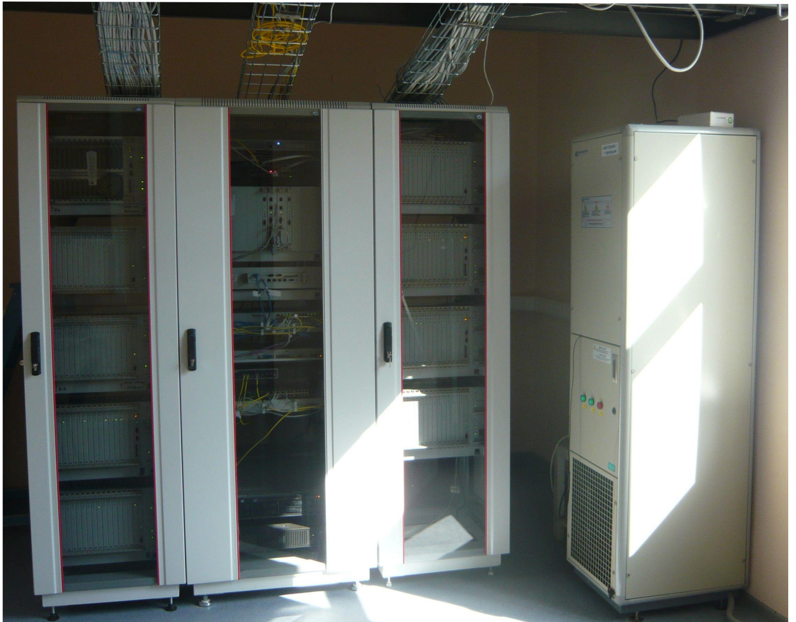
Цифровая АТС «МС240» и сопряженное оборудование связи
