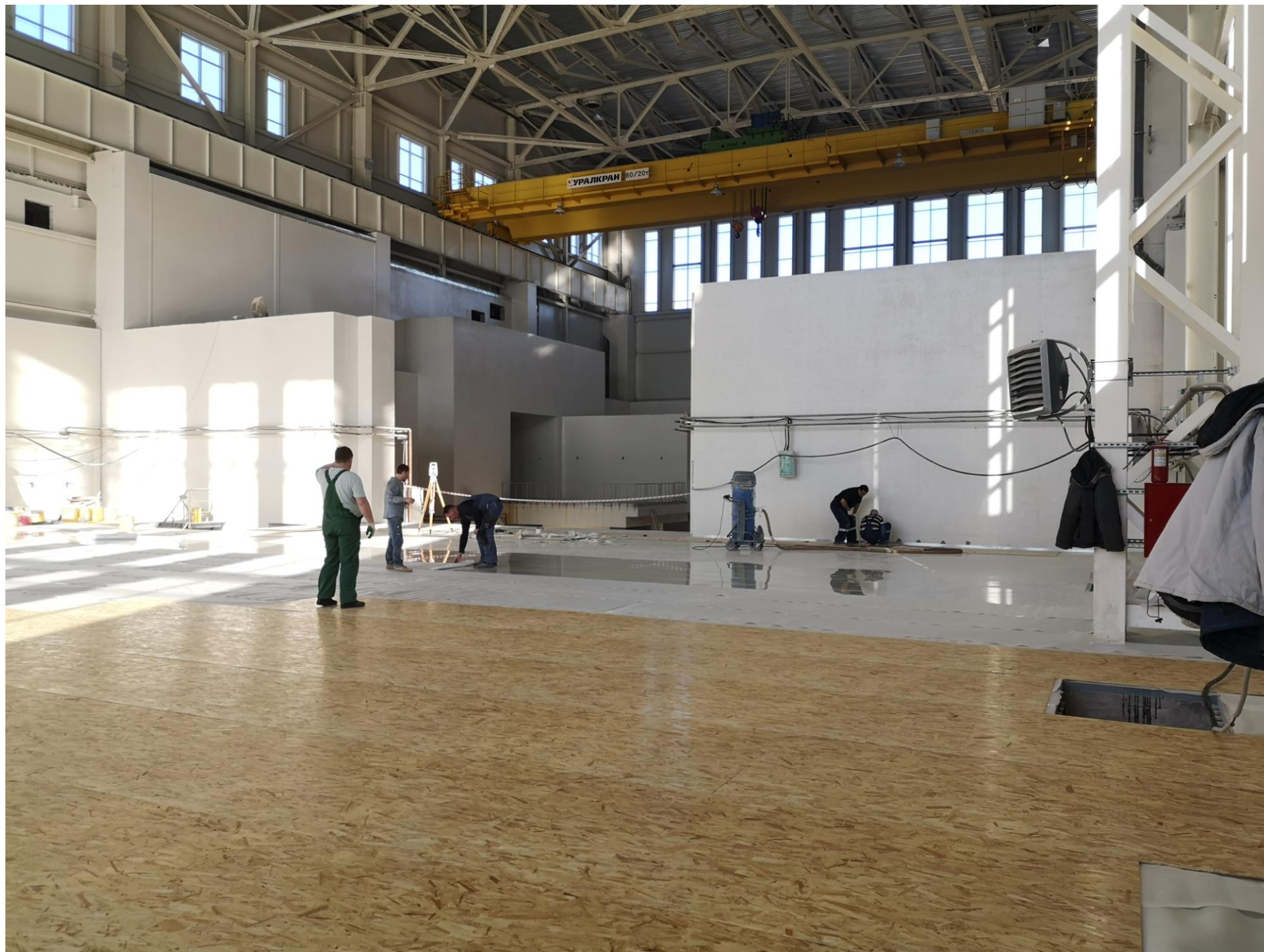
Укрытие фанерными листами наливных полов в зале разгрузки от механических повреждений. Начало марта.
