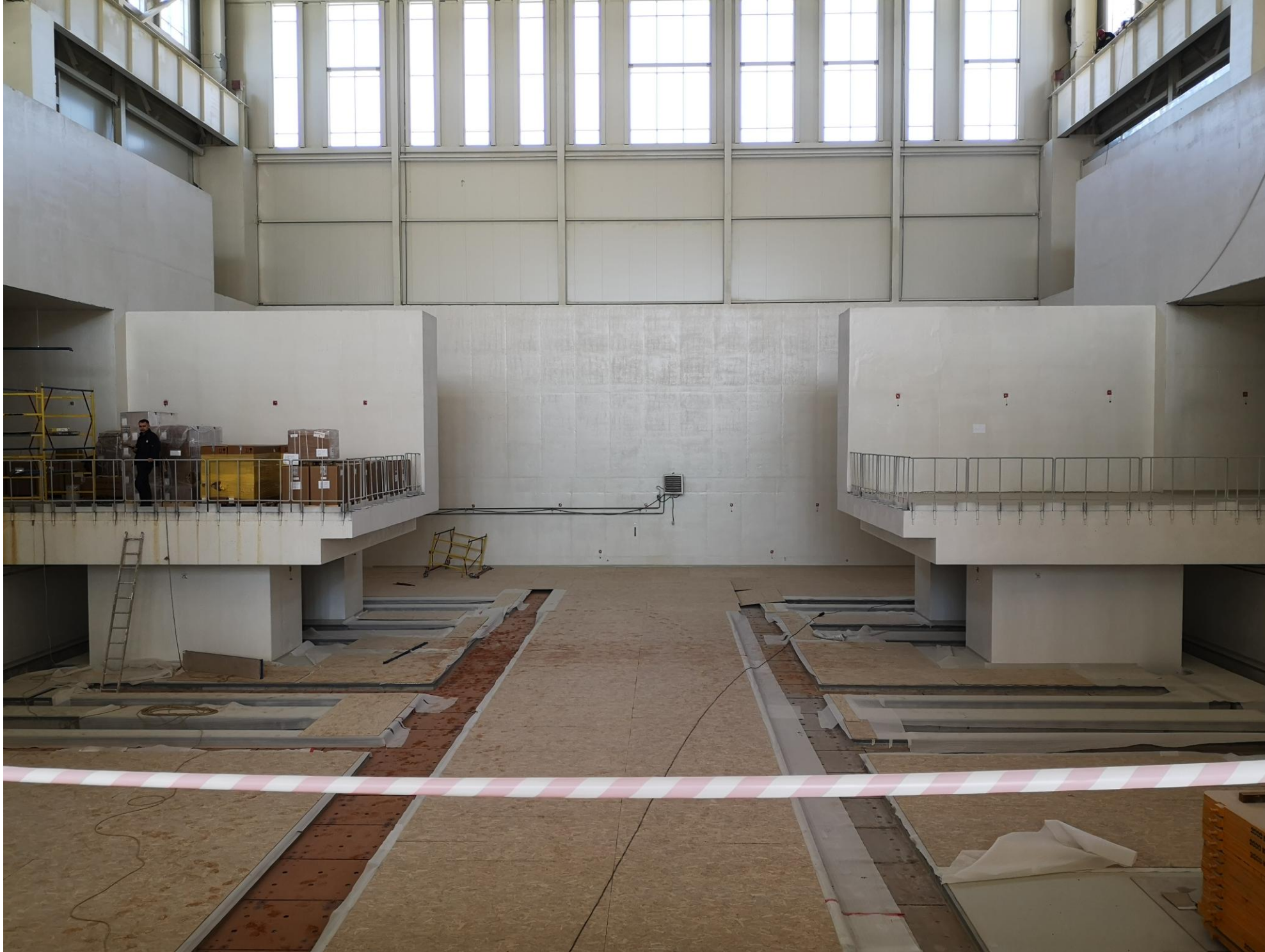
Вид на балконы прямка. Полы не полностью укрыты фанерой.
