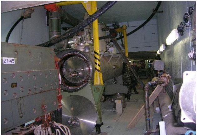
RF1 дефлектор в канале
