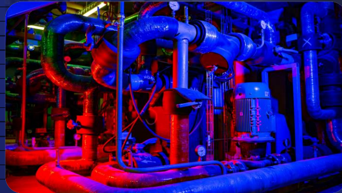
Насос и теплообменник сухой градирни
