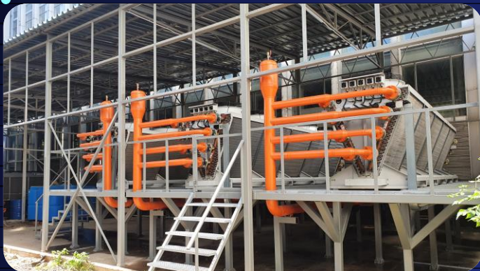
Сухие градирни системы охлаждения МИВК
