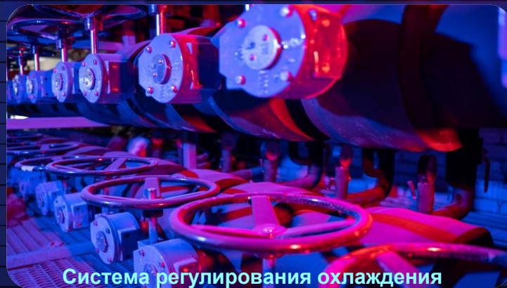
Система подачи охлажденной воды в межрядные кондиционеры
