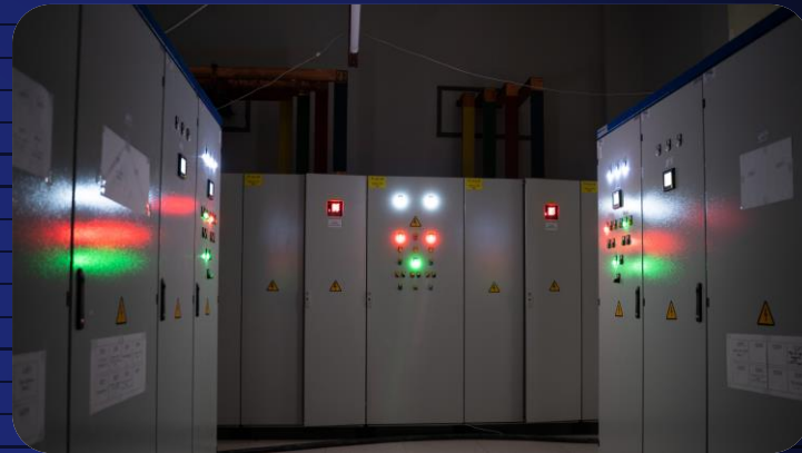
Главный распределительный щит
