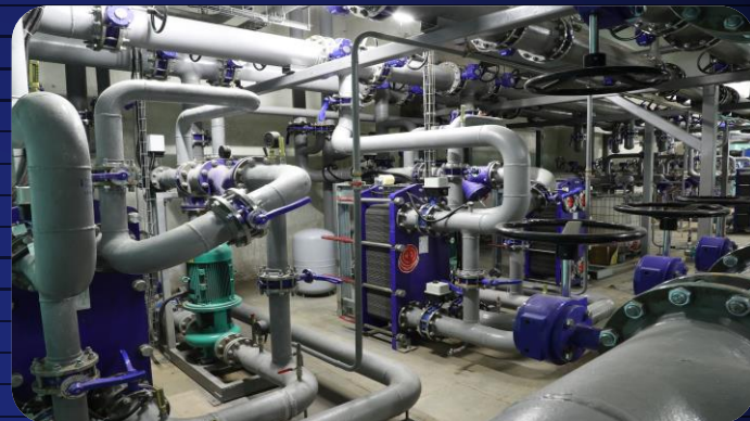
Охлаждение зала МИВК (-1 этаж здания ЛИТ)
