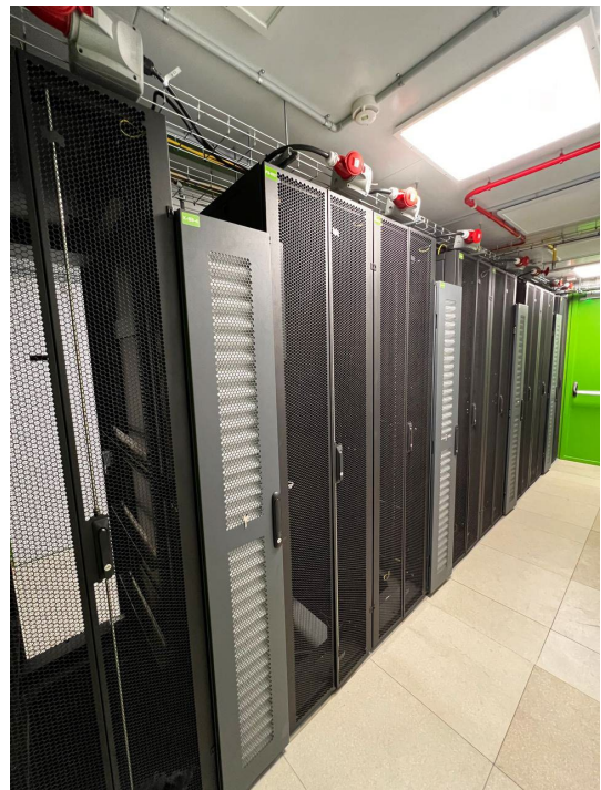
Fig 3.10.2. Racks and fan coils
