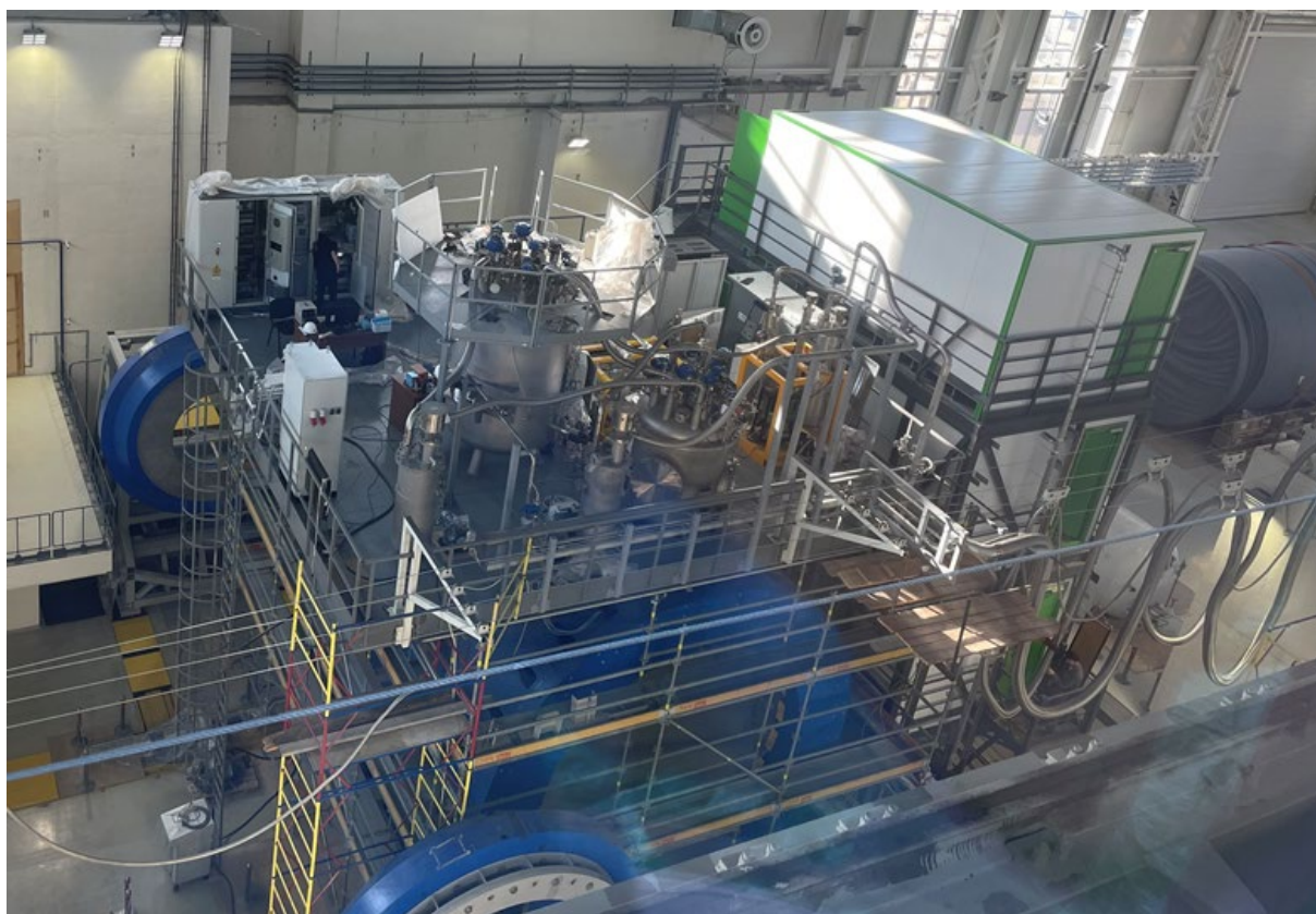
Рис 3.2.8. Общий вид технологической платформы, с установленным оборудованием.
