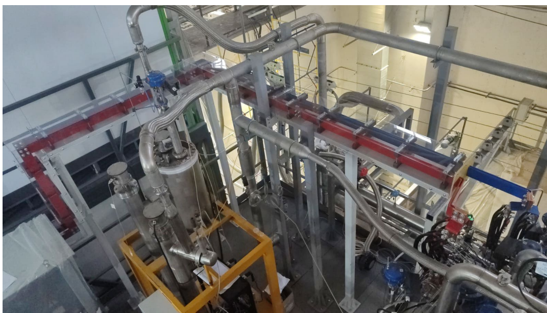
Рис 3.2.11. Шинопровод от внешнего сопротивления до тоководов магнита.
