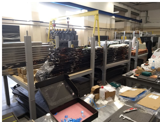
Рис. 3.7.7. Системы водяного охлаждения перед установкой.
