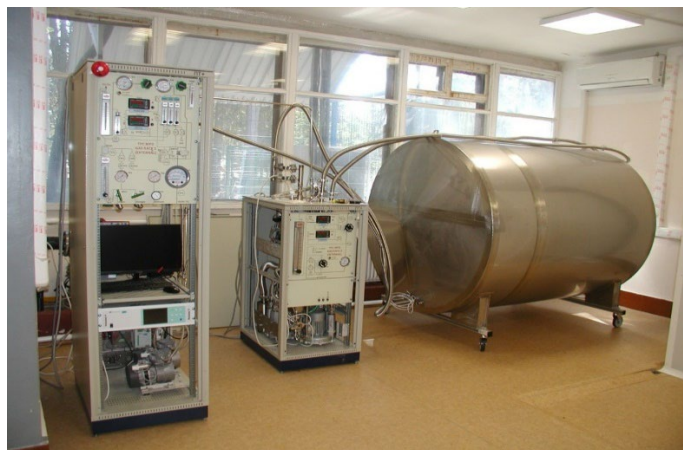
Рис. 3.3.5. Тестирование газовой системы с тестовым объемом в корп.217 ЛФВЭ.
