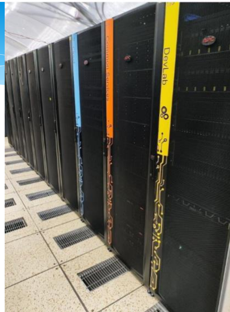
Разработаны эскизы для цветовой маркировки шкафов с оборудованием
