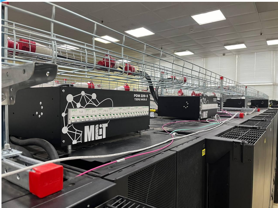
Разработка, сборка, монтаж и подключение модулей распределения питания для модуля №3 МИВК
